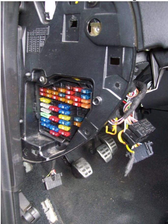
Bild 5: So Siehts dann aus: Sicherungskasten und abgezogene Stecker
